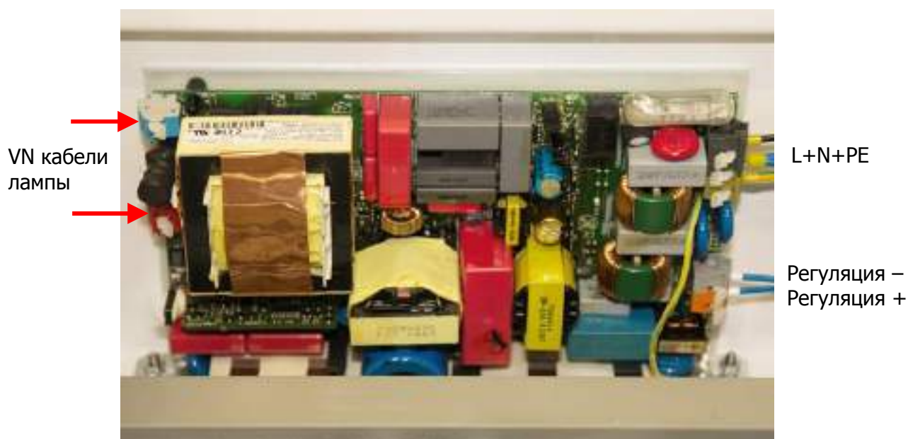
Рис. 14 Подключение проводов в электронном балласте
